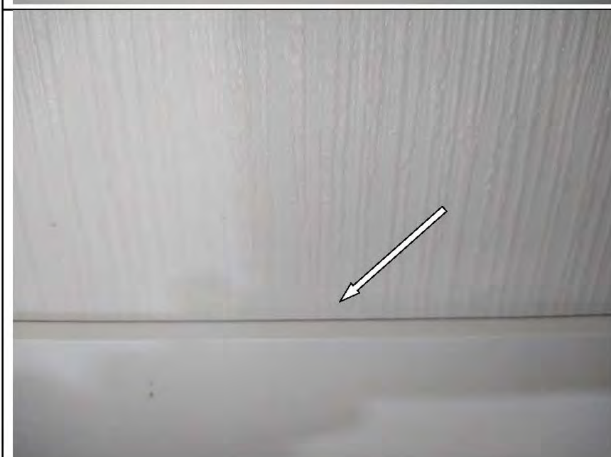
Фото №51. Неплотное прилегание дверного наличника к стене в кухне.
