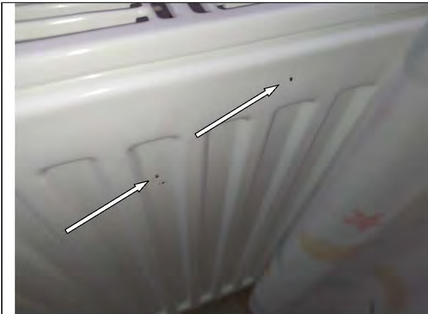
Фото №34. Отопительный прибор имеет дефект покраски защитного кожуха в спальне.
