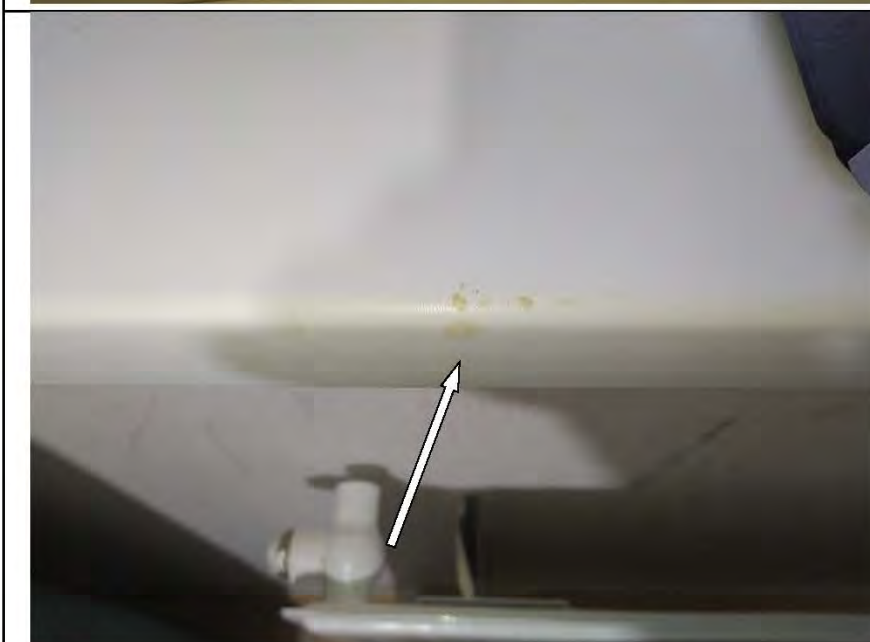
Фото №29. На лицевой поверхности подоконной доски в кухне имеются дефекты (загрязнение малярными составами).
