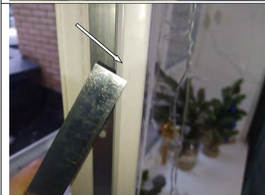
Фото №23. Профиль ПВХ оконного блока в кухне имеет дефекты (царапина).
