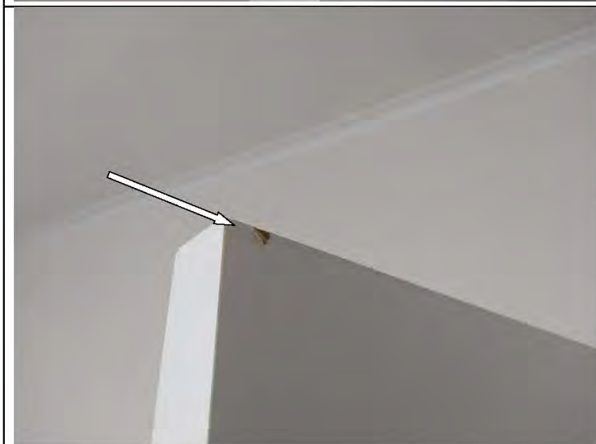
Фото №48. Дефекты (скол) на лицевой поверхности полотна деревянного дверного блока в кухне.
