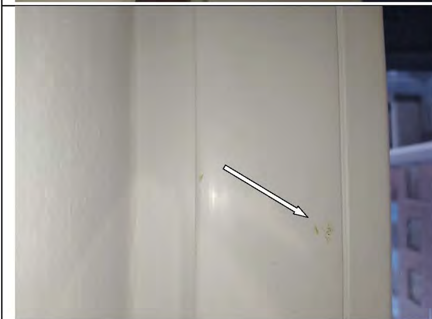
Фото №27. Профиль ПВХ оконного блока в гостиной имеет дефекты (загрязнение малярными составами).
