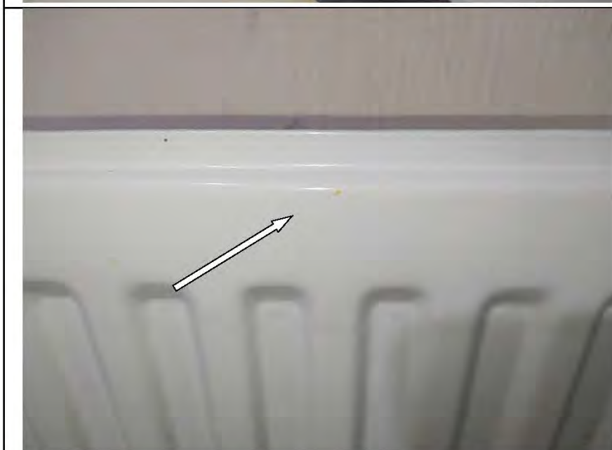
Фото №32. Радиатор в кухне имеет дефекты (загрязнение монтажной пеной).
