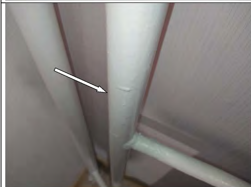
Фото №69. Окрашивание труб отопления выполнено с дефектами в гостиной (подтеки)
