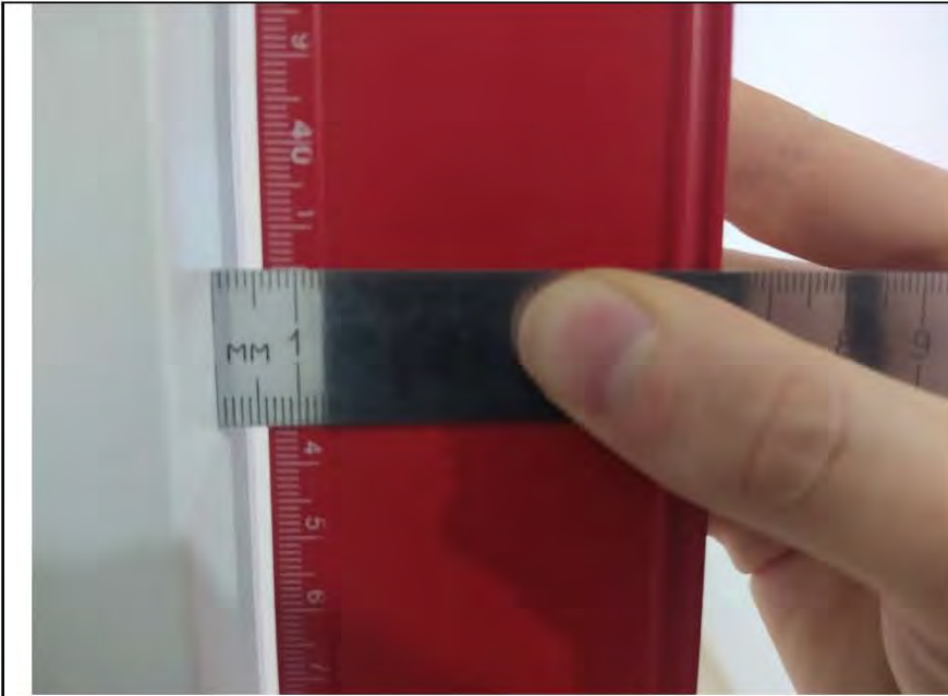
Фото №37. Отклонение коробки дверного блока в гостиной.
