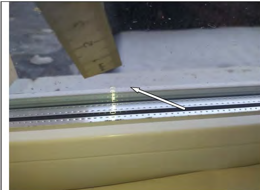
Фото №28. На стеклопакете оконного блока в гостиной имеется дефект (царапина).
