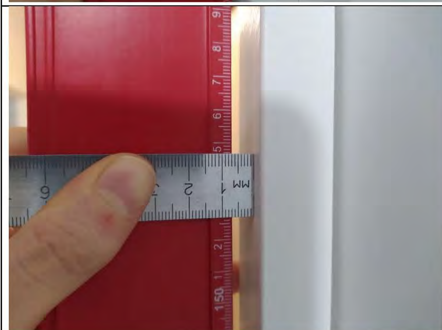
Фото №39. Отклонение коробки дверного блока в ванной комнате.
