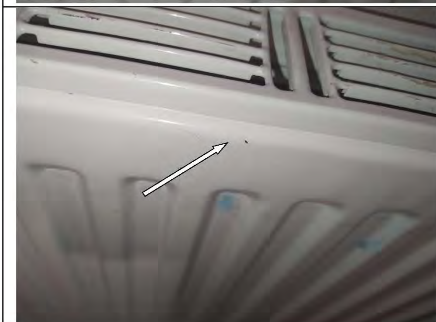
Фото №33. Отопительный прибор имеет дефект покраски защитного кожуха в гостиной.
