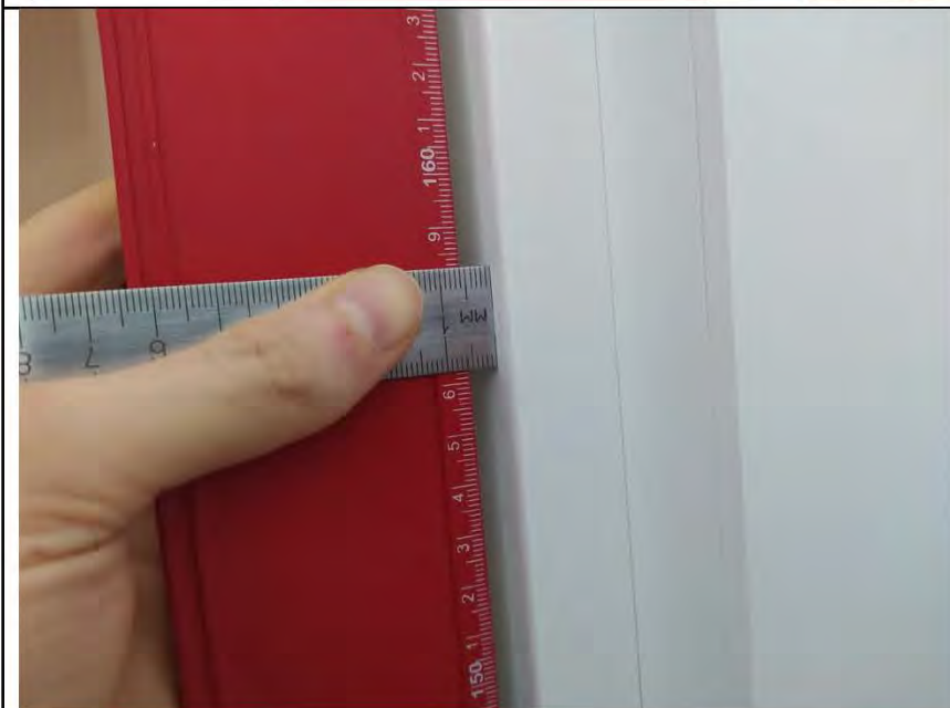
Фото №38. Отклонение коробки дверного блока в санузле.
