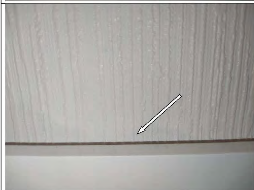
Фото №50. Неплотное прилегание дверного наличника к стене в гостиной.
