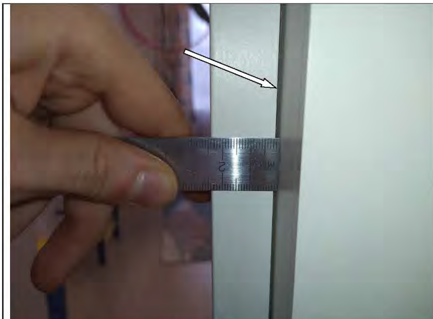
Фото №46. Элементы дверного блока соединены не надежно в спальне.
