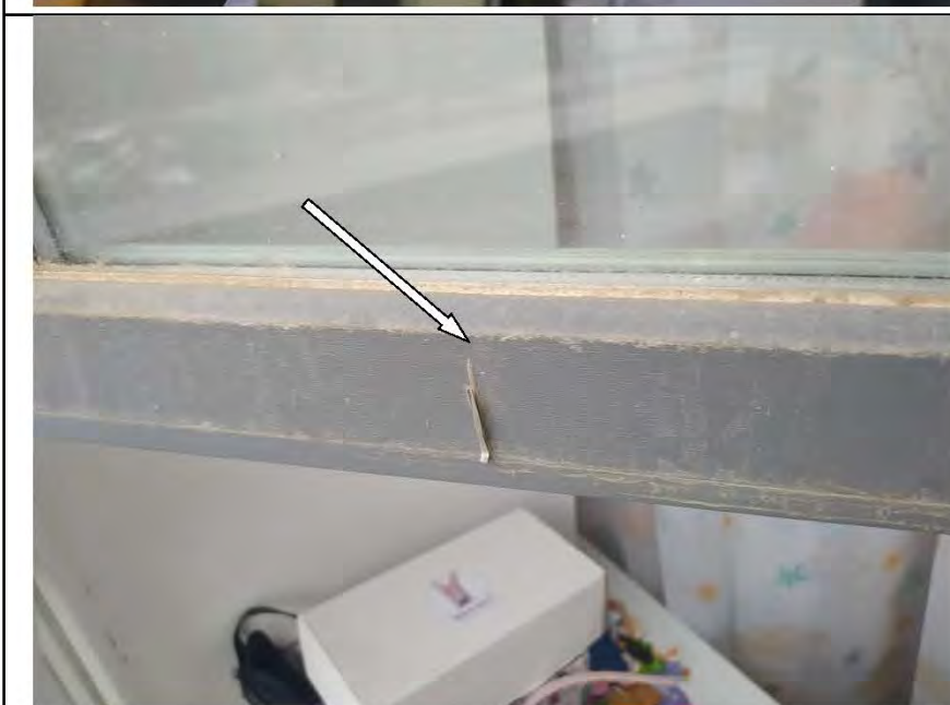
Фото №24. Профиль ПВХ оконного блока в спальне имеет дефекты (загрязнение малярными составами).
