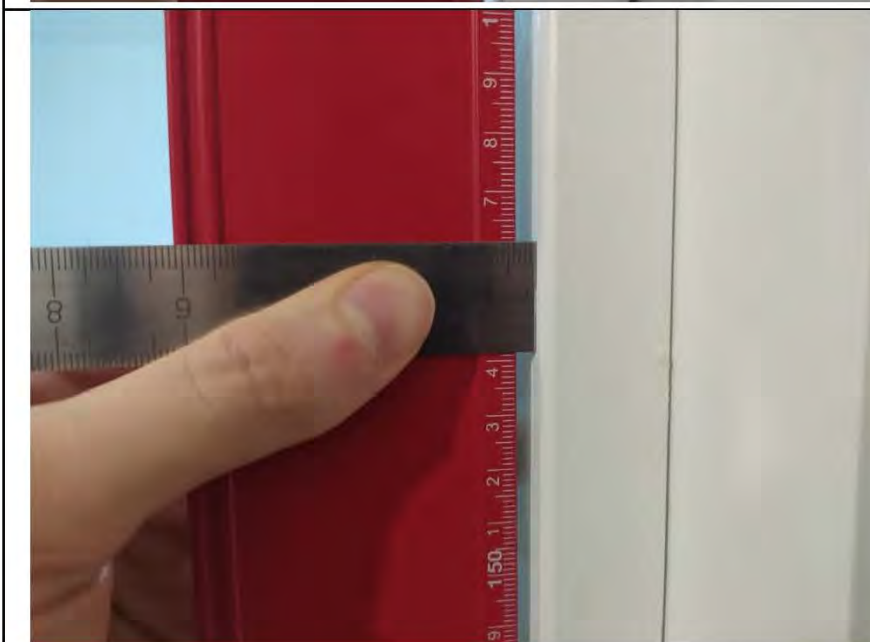
Фото №36. Отклонение коробки дверного блока в кухне.
