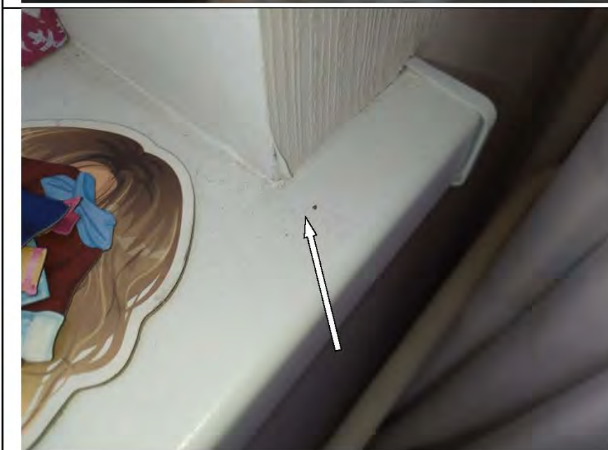
Фото №30. На лицевой поверхности подоконной доски в спальне имеются дефекты (царапина).
