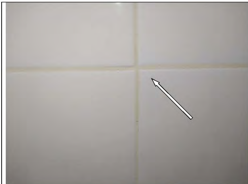
Фото №58. Затирка настенной плитки в ванной комнате выполнена с нарушениями.
