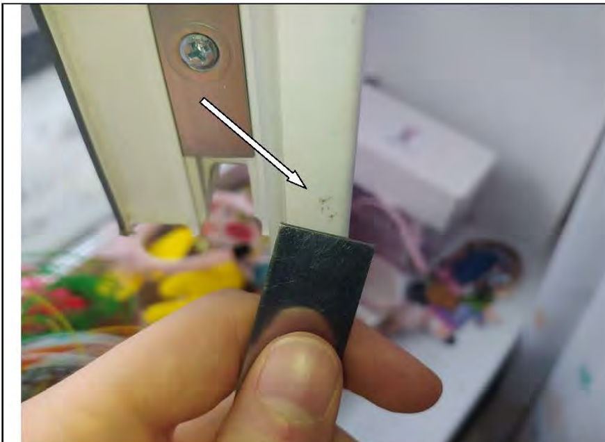
Фото №25. Профиль ПВХ оконного блока в спальне имеет дефекты (скол).
