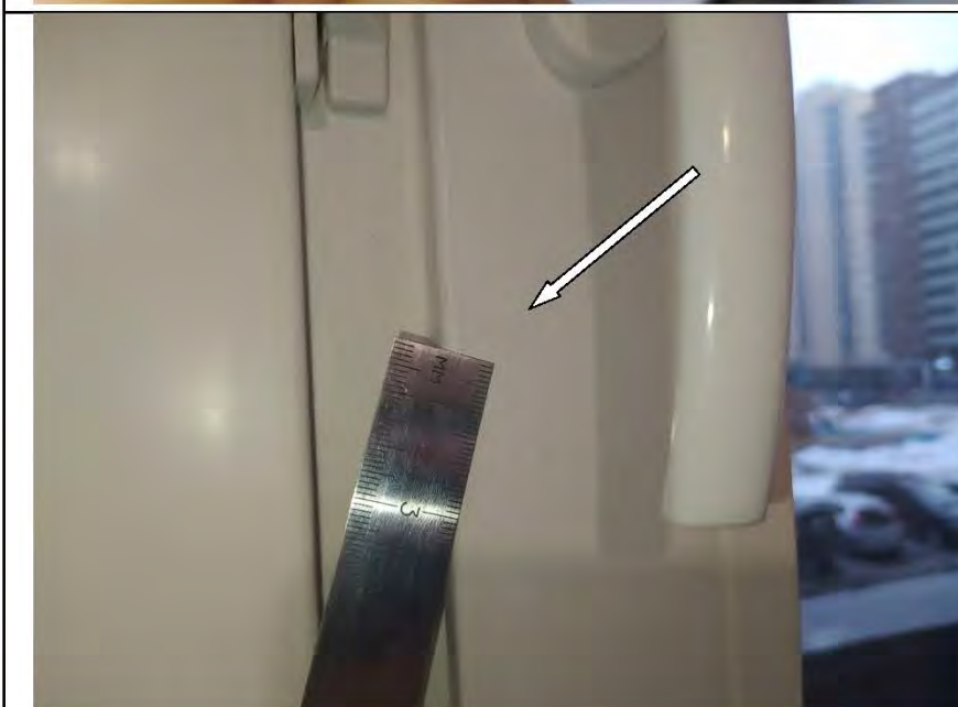
Фото №26. Профиль ПВХ оконного блока в гостиной имеет дефекты (царапина).
