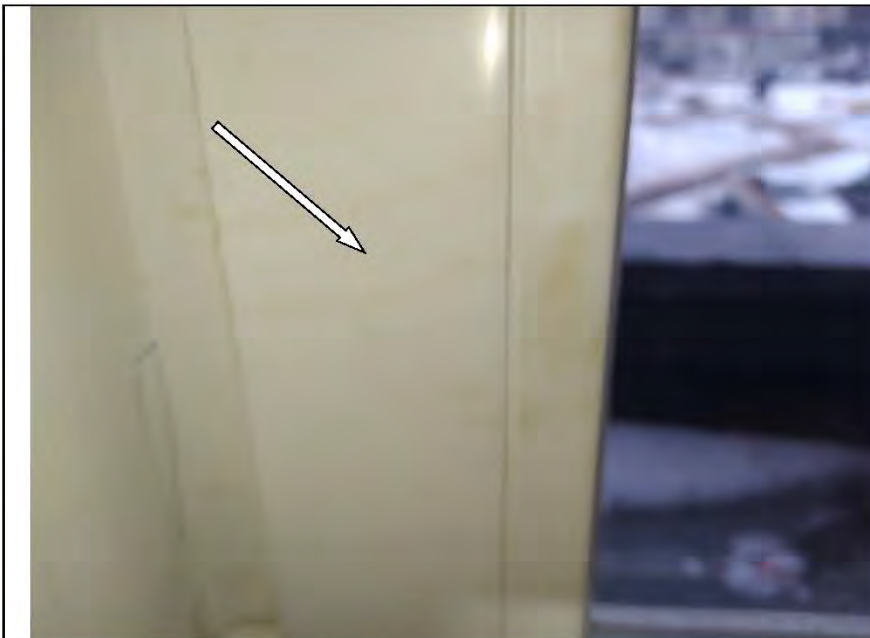
Фото №22. Профиль ПВХ оконного блока в кухне имеет дефекты (загрязнение малярными составами).
