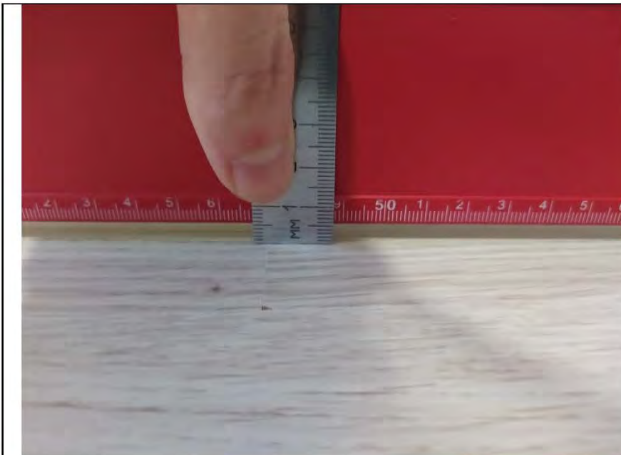
Фото №13. Измерения уровня напольного покрытия в гостиной.
