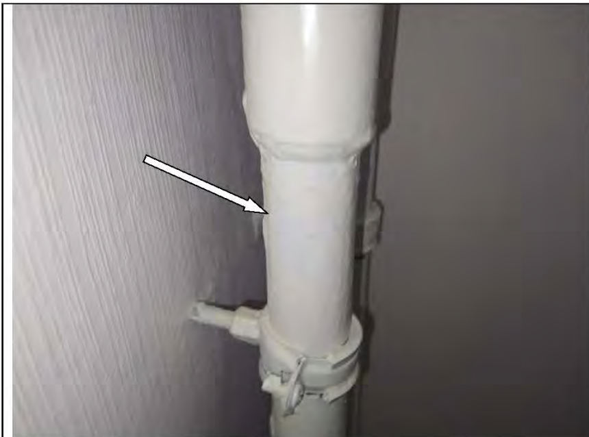
Фото №70. Окрашивание труб отопления выполнено с дефектами в кухне (подтеки)
