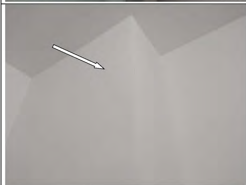
Фото №72. Отсутствие вывода вентиляционного канала в ванной комнате.
