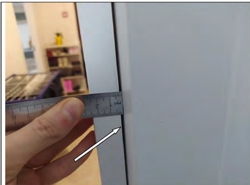
Фото №43. Элементы дверного блока соединены не надежно в ванной комнате.
