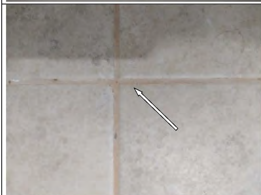
Фото №59. Затирка напольной плитки выполнена с нарушениями в ванной комнате: разность ширины шва.
