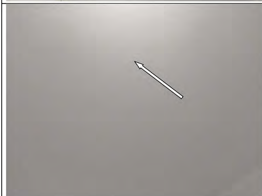
Фото №66. На отштукатуренном потолке зафиксированы различные дефекты в спальне (полосы).
