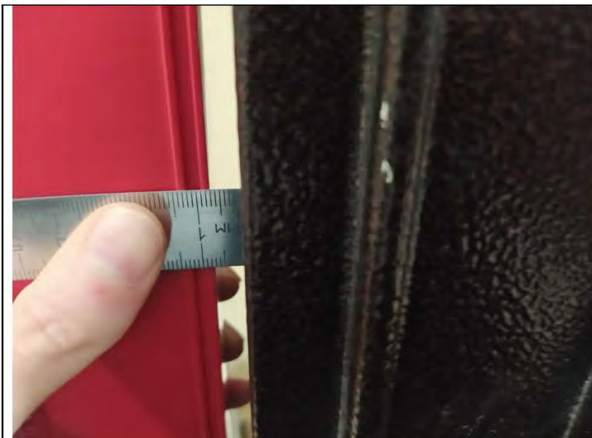
Фото №67. Отклонение коробки входного дверного блока
