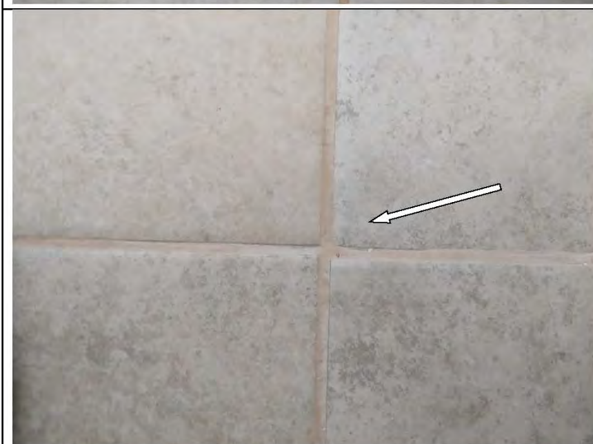
Фото №62. Затирка напольной плитки выполнена с нарушениями в санузле: разность ширины шва.
