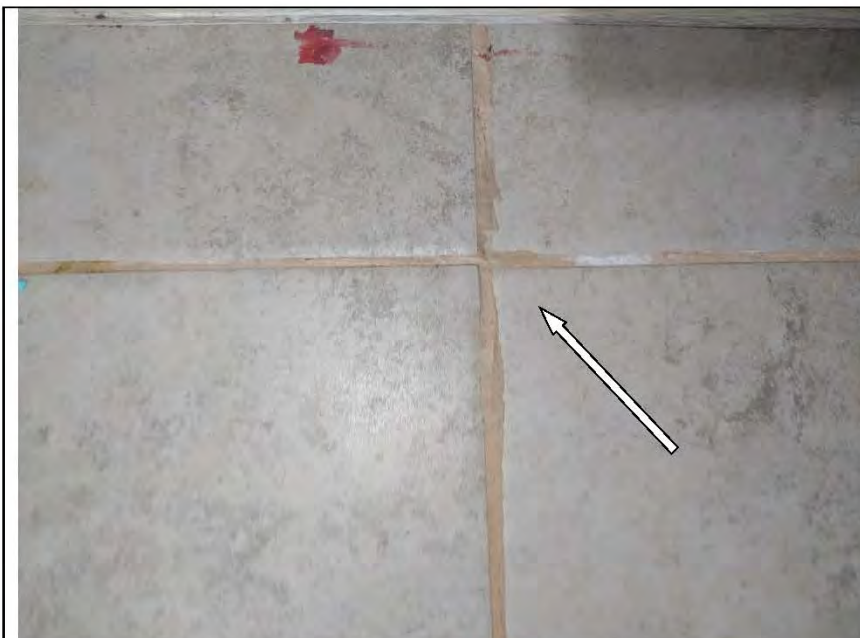
Фото №61. Затирка напольной плитки выполнена с нарушениями в кухне: разность ширины шва.
