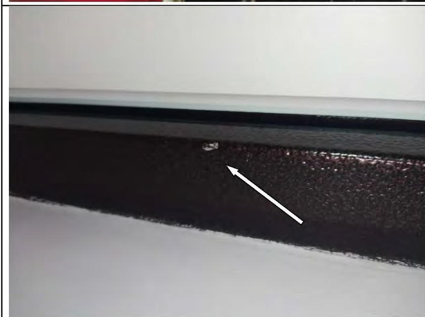
Фото №68. Коробка входной металлической двери имеет дефекты (загрязнение малярными составами).
