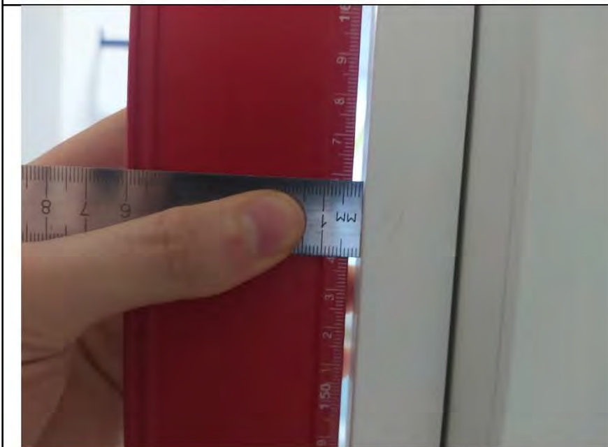
Фото №35. Отклонение коробки дверного блока в спальне.
